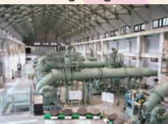
館内には 10 台の 巨大ポンプが残る
